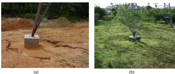
Figura 7 - Degradação do solo e medidas mitigadoras: a) Degradação do solo, erosão no entorno da base da fundação, b) Cobertura vegetal de gramíneas, recuperação da área degradada.
