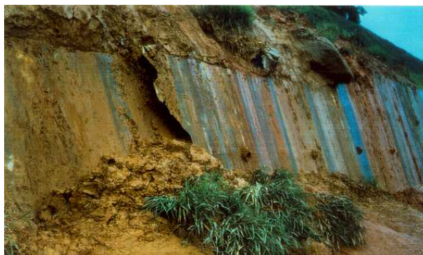
Figura 2: Detalhe do muro após ruptura (Vasconcellos, 1997).
