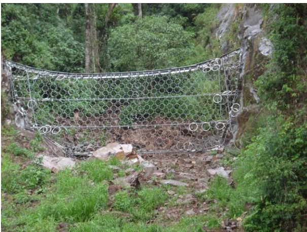
Figura 11: Fotografia atual da barreira contra fluxo de detritos já montada
