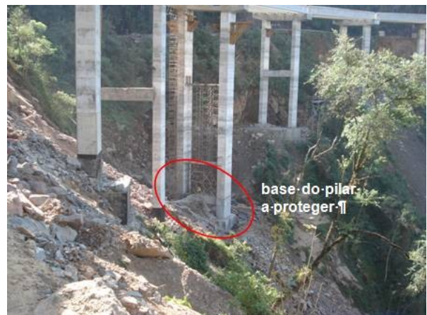
Figura 6. Vista do pilar do viaduto sujeito ao risco de impacto de material proveniente de processos de instabilidade.
