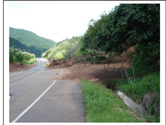
Figura 2. Pé da ruptura. Material invadiu e bloqueou a rodovia.
