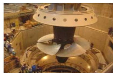
Rotor da 3ª unidade geradora
